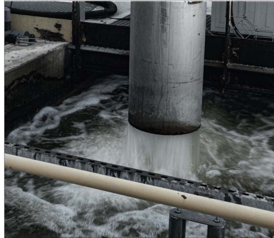
↑ Effluent clarifié, après neutralisation (traitement station CO 2 ), Usine de Gardanne (2022).
