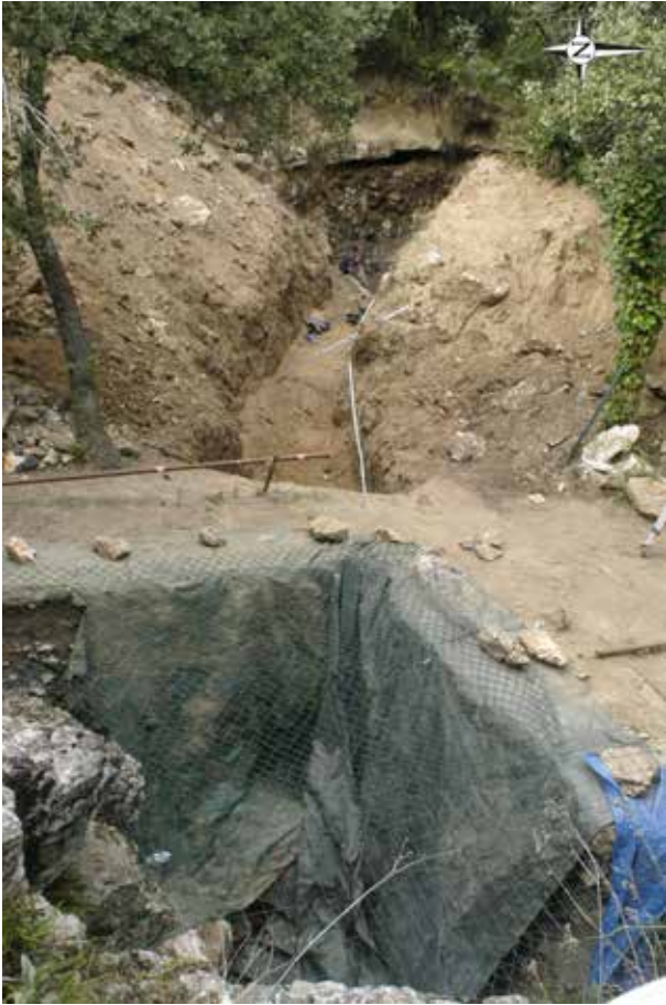
FIG. 4. Photographie générale de la tranchée réalisée en perpendiculaire de l'axe du vallon entre les deux versants. On voit au fond se dessiner le tronçon Ouest de la galerie recoupée par le vallon. Cliché C. Manen.
