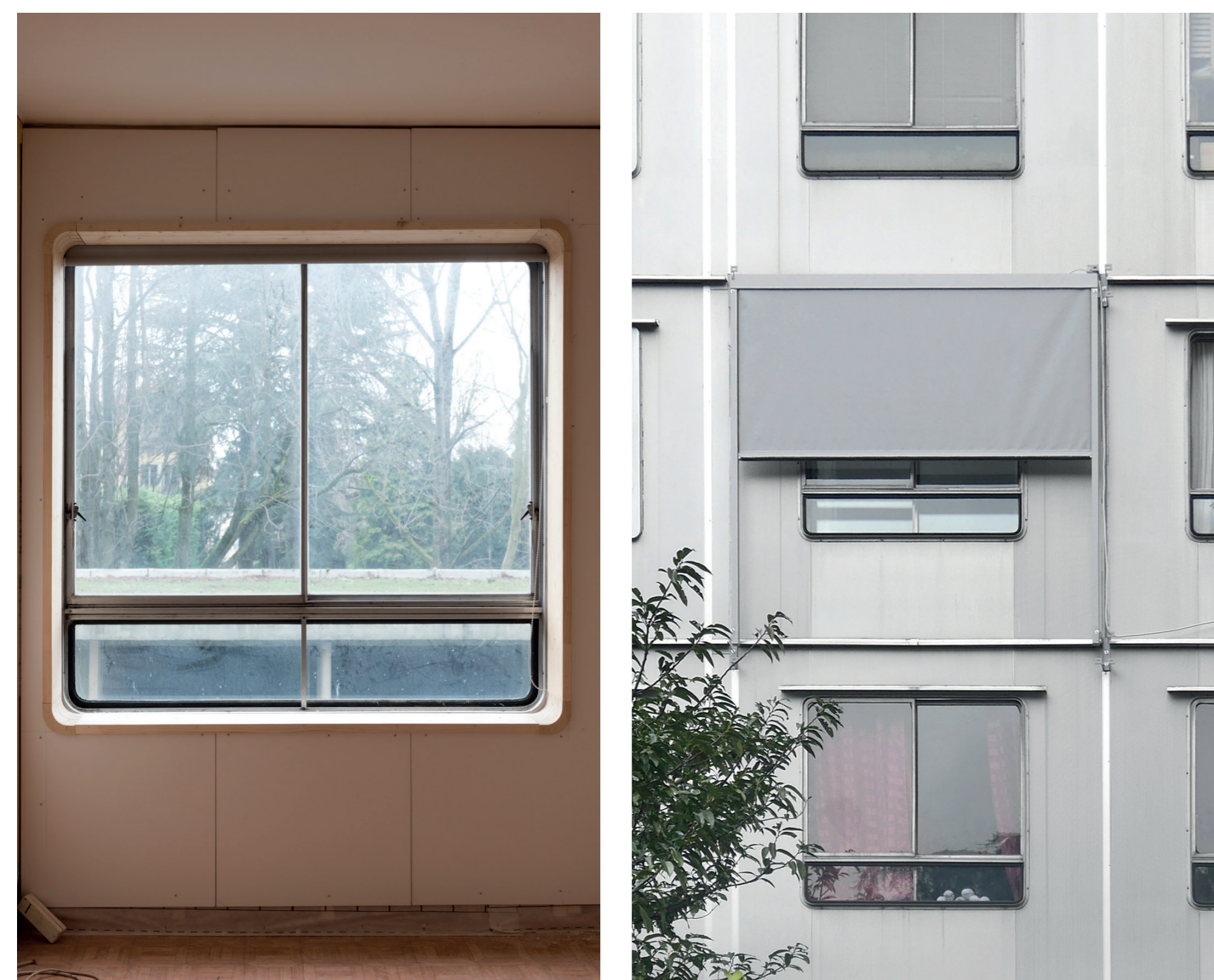
Prototype pour la réhabilitation des façades légères installés sur l'immeuble Les Cèdres
