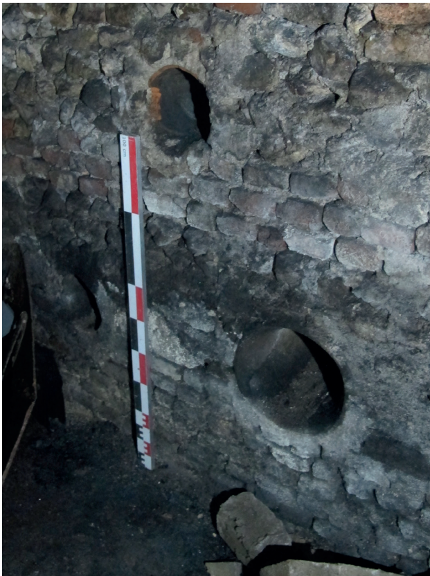
Fig. 8 : Orléans, maison n° 75 rue des Carmes : conduits d'aération dans une paroi de cloisonnement de la cave-carrière (cliché : Israël NAJERA-MARCOS, Pôle d'Archéologie Ville d'Orléans).
