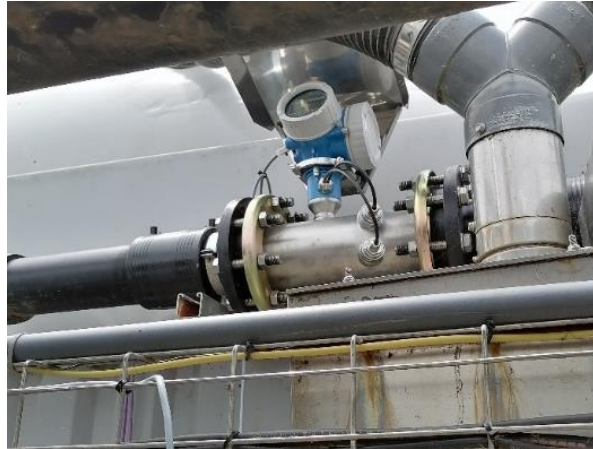
Figure 1: Débitmètre à ultrason sur la canalisation en sortie d'un digesteur de type garage (GAEC des Vallons)
