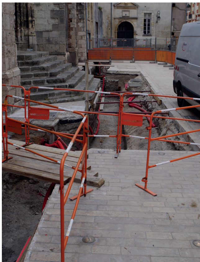
Fig. 7 : Partie sud de la tranchée. Son extrémité sud se situe au-delà des barrières (PAVO).
