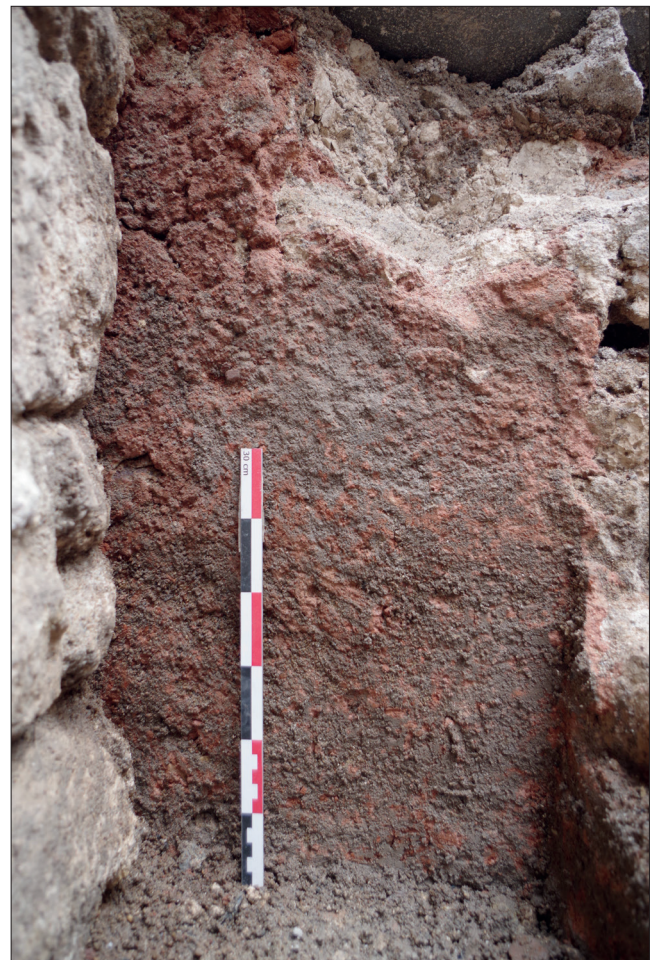
Fig. 39 : Enduit de tuileau US 1060 recouvrant ici le mur sud de F 115 (PAVO).
