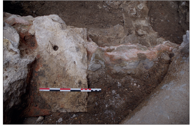
Fig. 46 : Trou de fixation d'une possible grille à l'entrée dans l'«aqueduc» de 1841-1842 (PAVO).
