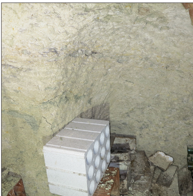
Fig. 32 : Premier niveau de cave, vue vers le sud de la cellule latérale ES_3 (cliché Cl. Alix, Pôle d'Archéologie, ville d'Orléans).
