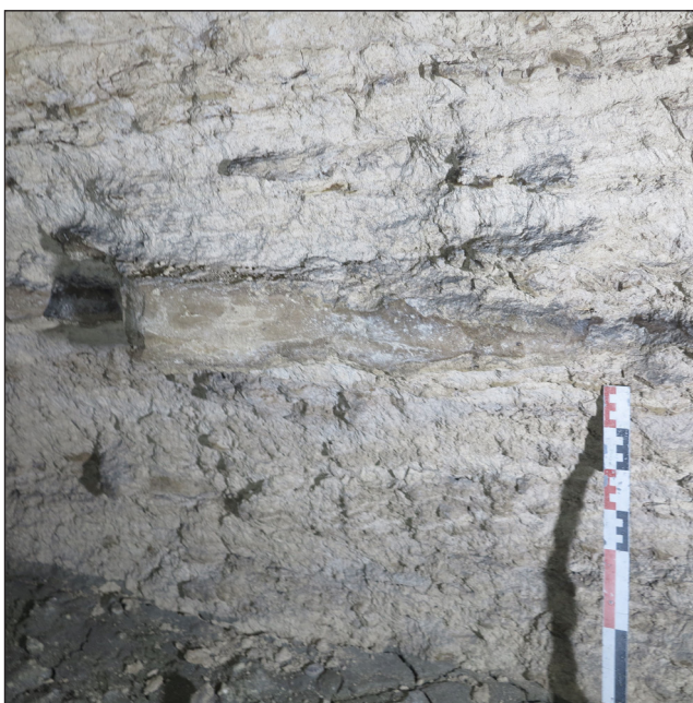
Fig. 40 : Deuxième niveau de cave (ES_7), vue vers le nord-est du banc de silex à la base du couvremment de la paroi orientale de la galerie nord (cliché Cl. Alix, Pôle d'Archéologie, ville d'Orléans).
