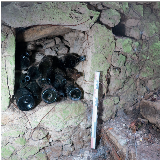
Fig. 44 : Vue de la niche NIC 614 dans la paroi nord de l'escalier, vers le nord (photographie n° 097 ; cliché : Cl. Alix).
