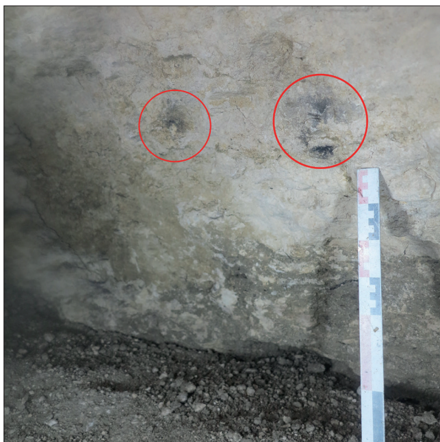
Fig. 64 : Vue des traces de suie sur la paroi sud de la galerie ES_16, vers le sud (photographie n° 055 ; cliché : Cl. Alix).
