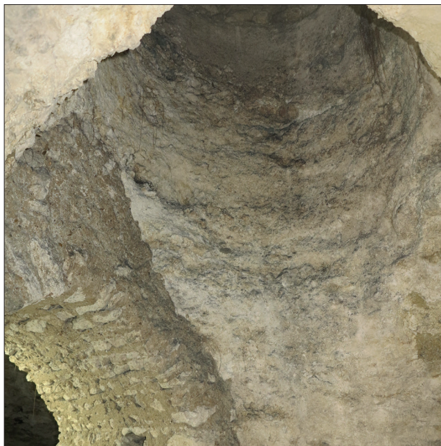
Fig. 50 : Vue de la voûte du passage maçonné (UC 6006) de la galerie ES_13, jouxtant le conduit du puits PUI 613, contre-plongée vers l'ouest (photographie n° 068 ; cliché : Cl. Alix).
