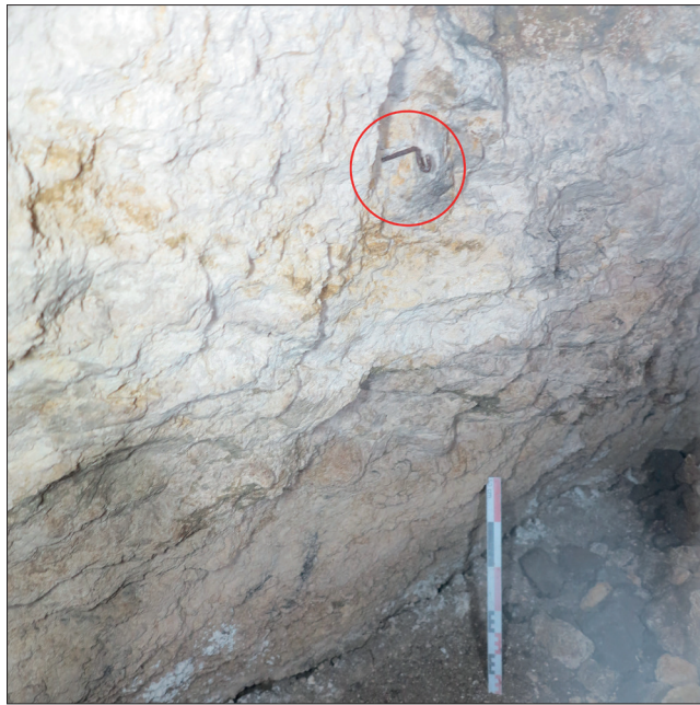
Fig. 60 : Vue d'un crochet fiché dans la paroi ouest de la galerie ES_14, vers le nord (photographie n° 064 ; cliché : Cl. Alix).
