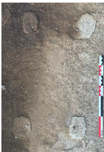
Fig.87 : Rebouchage ciment, US 3229 (photographie : J. Brangé).
