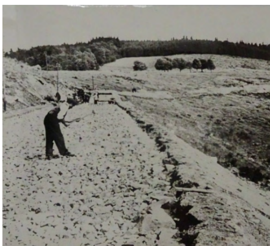
Fig.20 : Construction de la route menant à la carrière pour les civils et les livraisons de matériaux, vers 1941 (NATZ19_PH_ARCH_243, CERD).
