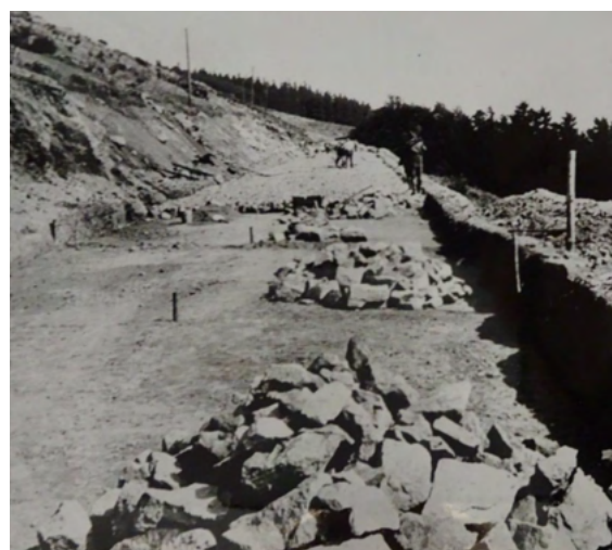
Fig.21 : Construction de la route menant à la carrière pour les civils et les livraisons de matériaux, vers 1941 (NATZ19_PH_ARCH_245, CERD).
