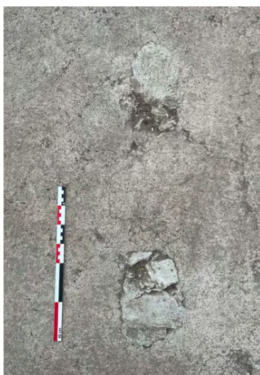
Fig.86 : Rebouchage ciment, US 3233 (photographie : J. Brangé).
