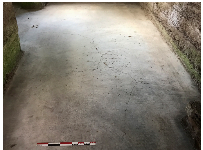
Figure 69 : Vue des impacts au sol (M. Landolt).
