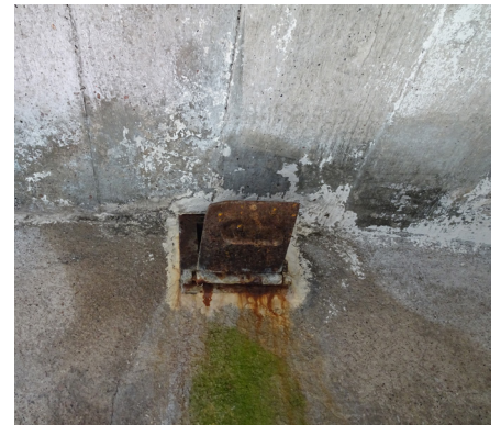
Figure 167 : Vue d'un des événements d'aération avec son clapet, ENA 098 (J. Brangé).
