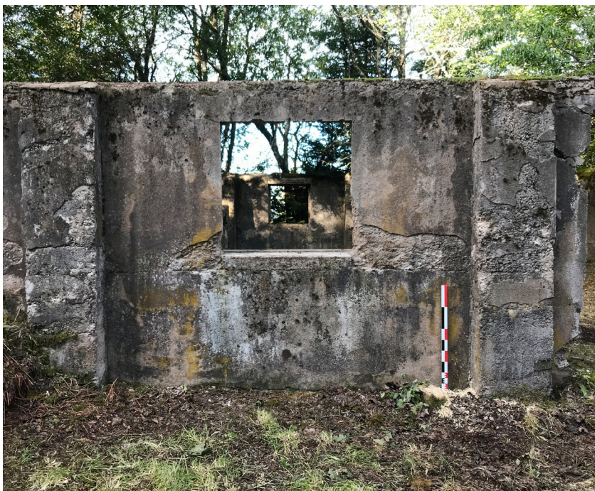
Figure 125 : Vue de la façade nord-est. On peut distinguer l'arrêt de coulage de béton sous l'appui de fenêtre (J. Brangé).
