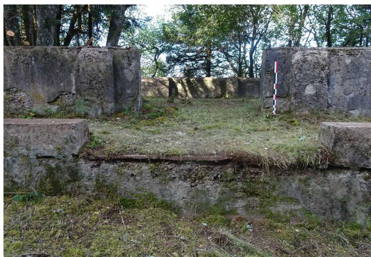
Figure 136 : Vue d'une des ouvertures dans le parapet de la coursive (M. Landolt).
