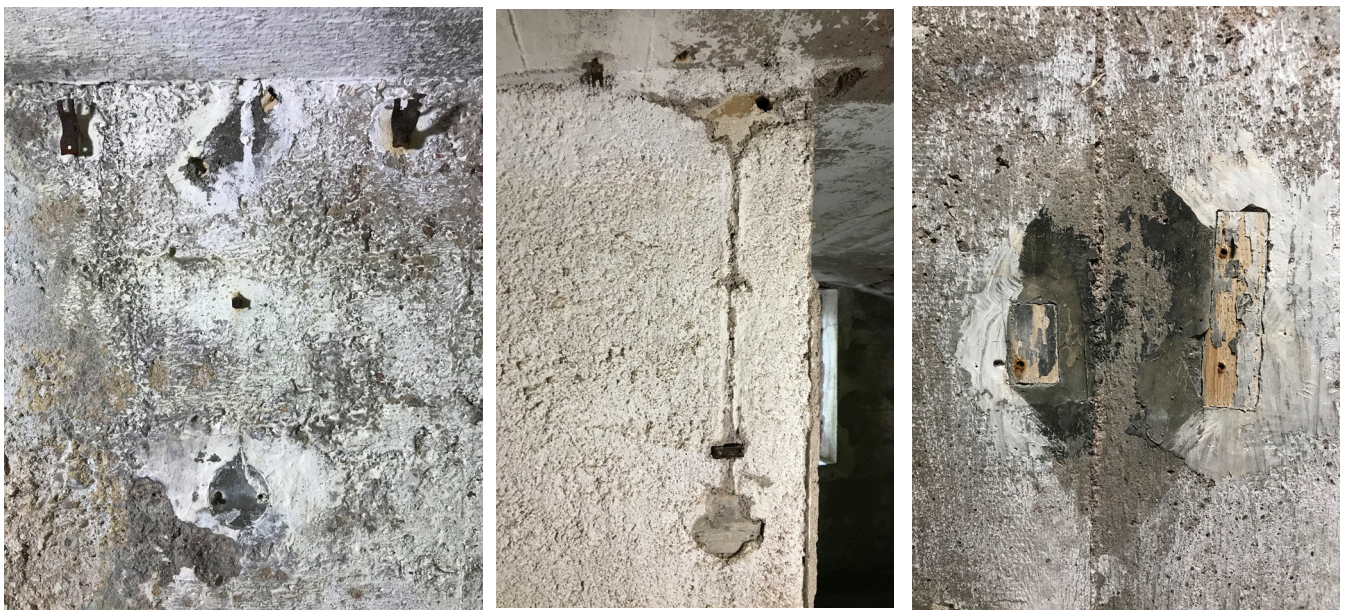
Figure 99 : Empreinte d'un interrupteur et Figure 100 : Empreinte d'un interrupteur, accroches métalliques des câbles électriques, pièce 3 (M. Landolt). pièce 2 (M. Landolt). Figure 101 : Empreinte d'un plafonnier, pièce 3 (M. Landolt).
