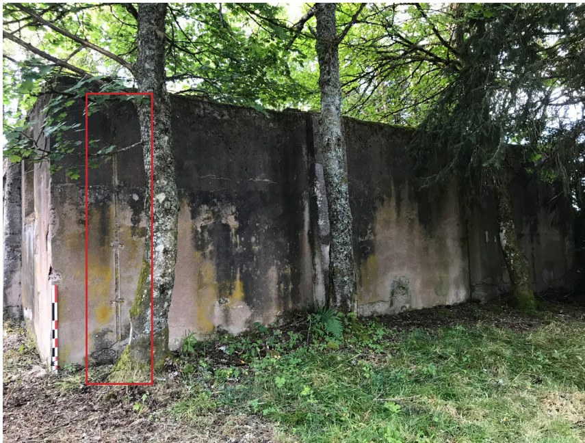
Figure 126 : Vue de la façade nord-ouest ; l'empreinte assimilée à une arrivée électrique est encadrée (J. Brangé).
