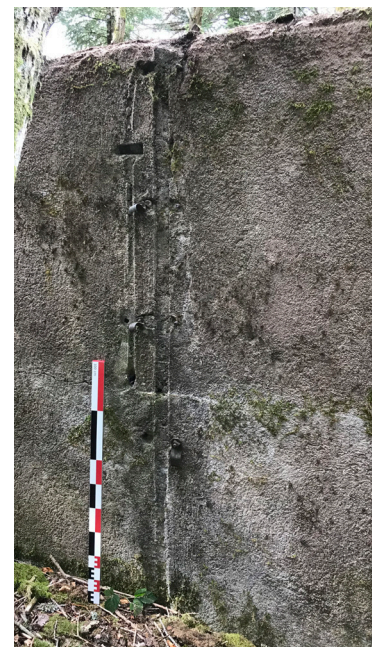
Figure 102 : Empreinte de l'arrivée électrique dans l'enduit du mur nord-est (M. Landolt).
