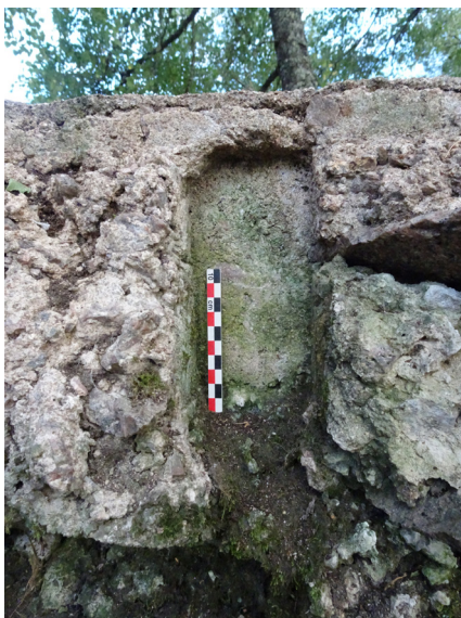
Figure 150 : Détail d'une empreinte de solive dans le massif en béton (M. Landolt).
