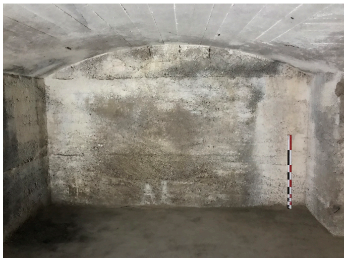
Figure 61 : Vue de l'intérieur de la pièce 6. Deux arrêts de coulage de béton sont nettement distinguables sur le mur. On peut également observer les empreintes des planches du coffrage de la voûte (M. Landolt).
