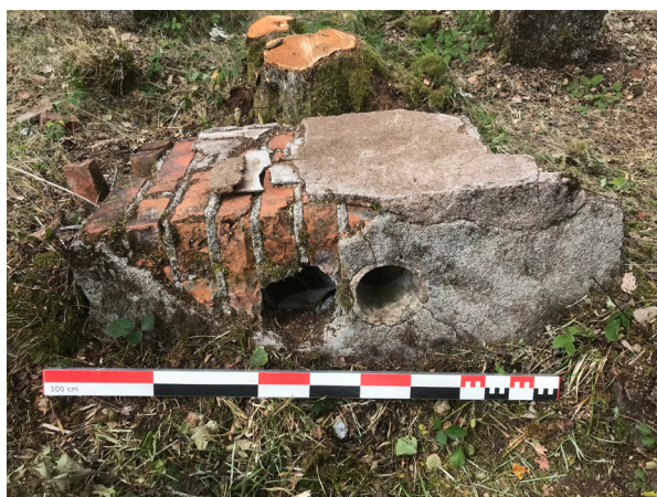
Figure 152 : Vue d'un conduit de cheminée écroulée, ELA 20 (J. Brangé).
