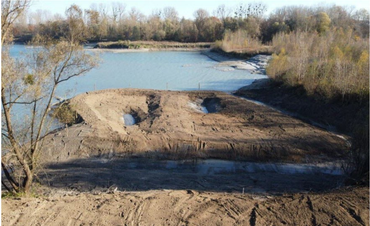
Chantier montrant la création de la roselière à Beinheim, phase de terrassement avant la renaturation en 2021. Source : Les Dernières Nouvelles d'Alsace (DNA), 2022.
