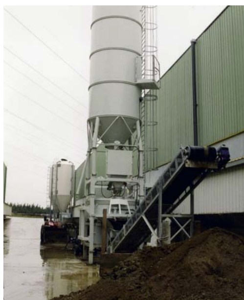
Fig.8.11: Installation de chaulage de fientes de poules pondeuses.
