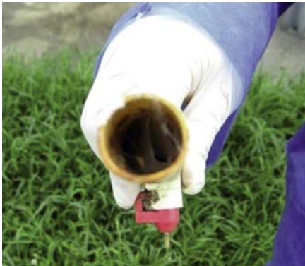
Fig.81.27: Dépôt de fer obstruant la conduite d'eau.
