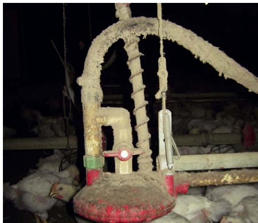
Fig.81.31: Problèmes de fer dans les canalisations et l'abreuvoir.
