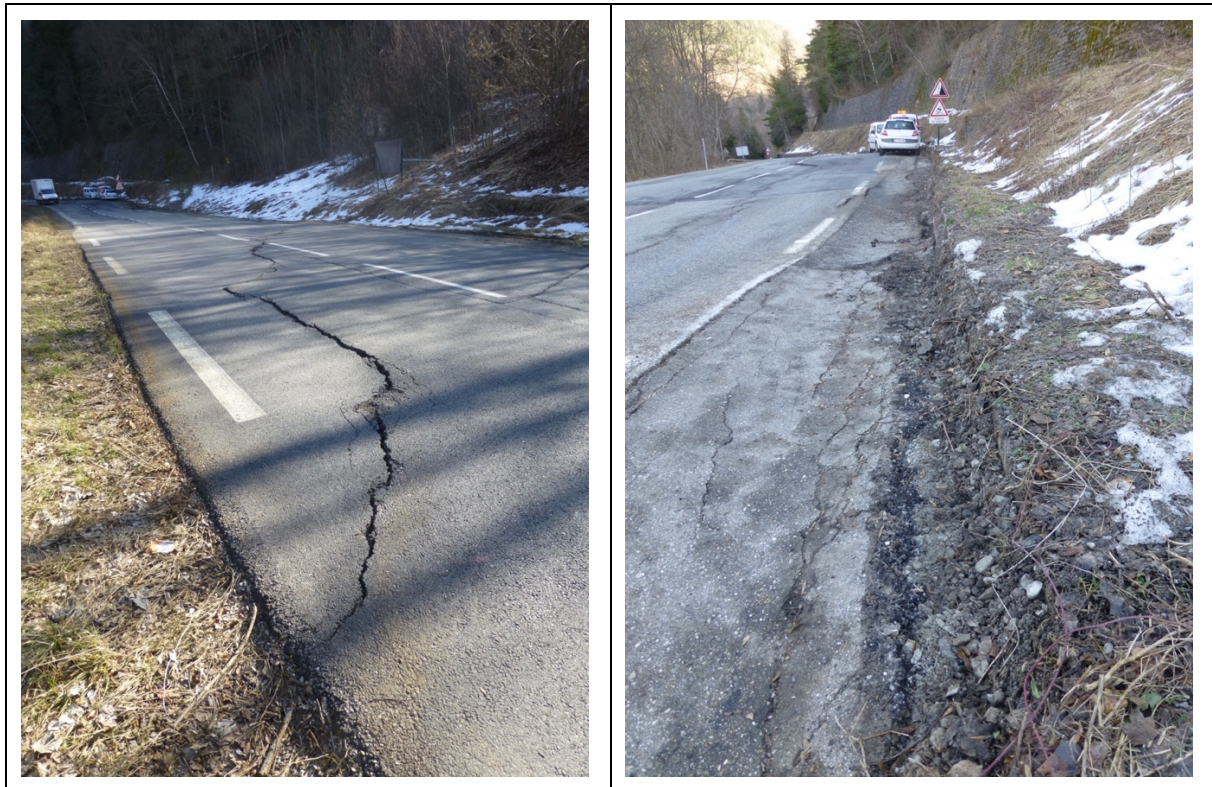
Photos 8 et 9 : Exemples de déformations de la RN 85 liées au glissement de Corps
