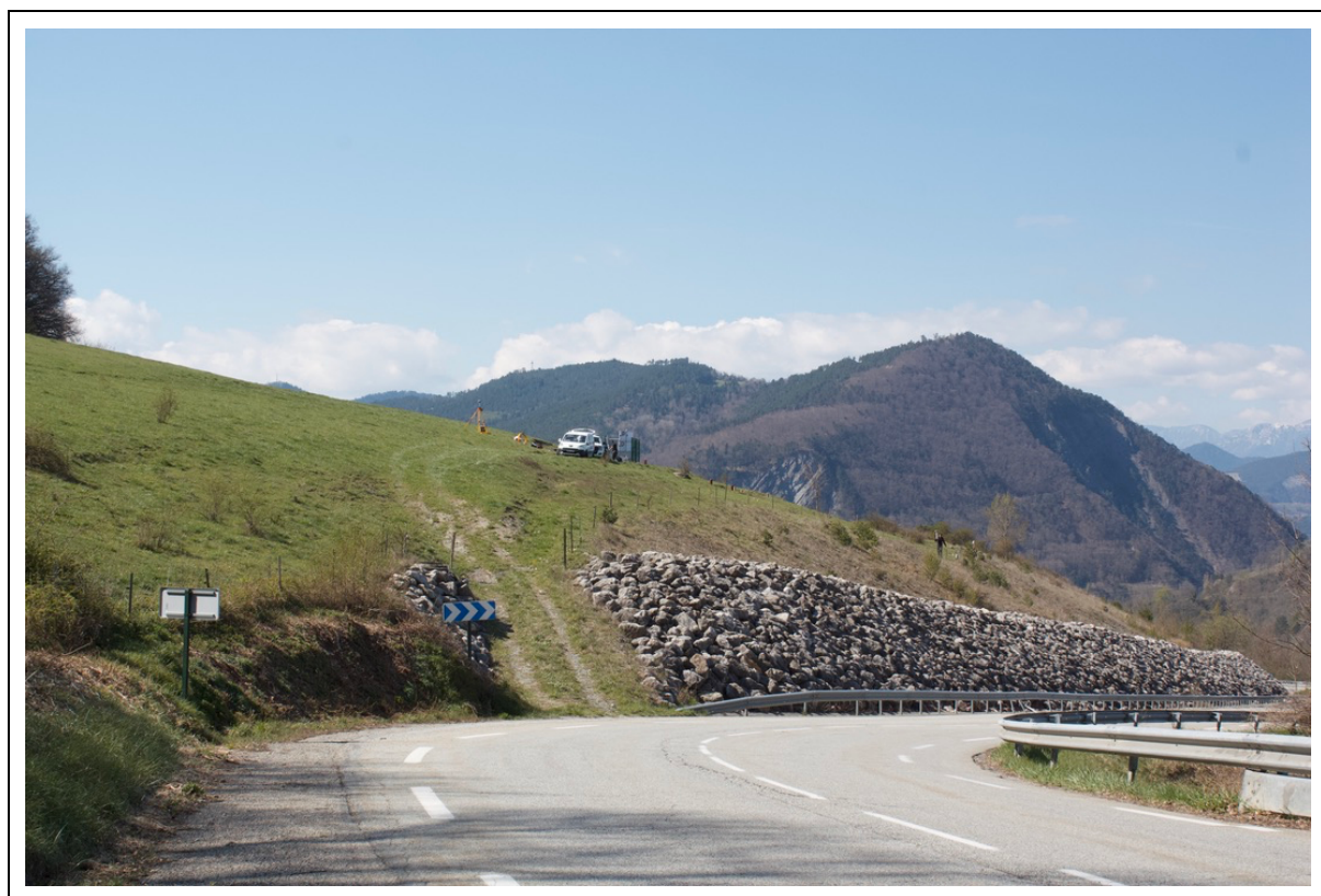
Photo 10 : Les travaux de confortement du site de Charlaix réalisés par le DIR
