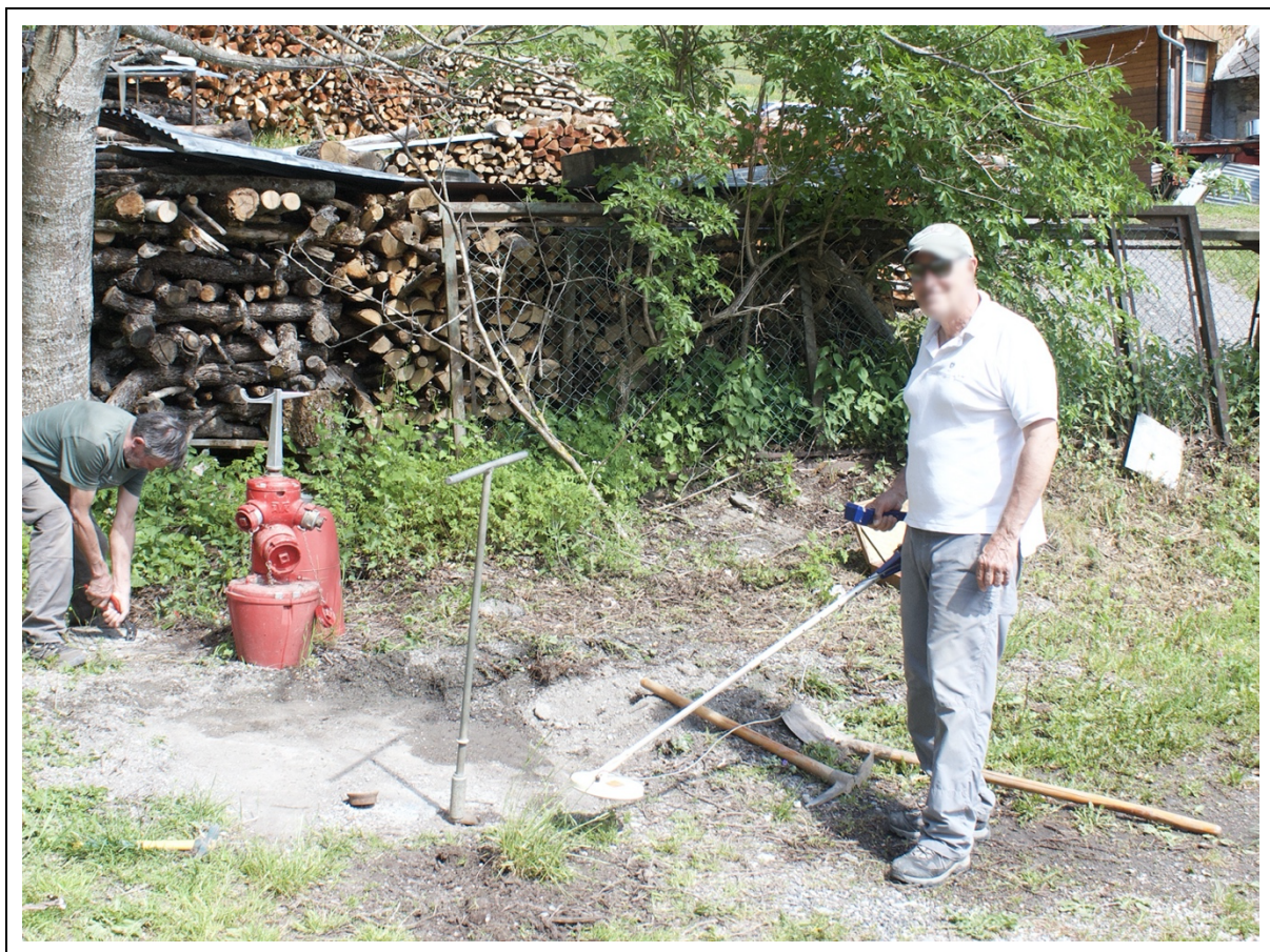
Photo 10 : Deux élus à la « chasse aux fuites » sur les canalisations d'eau de leur commune
