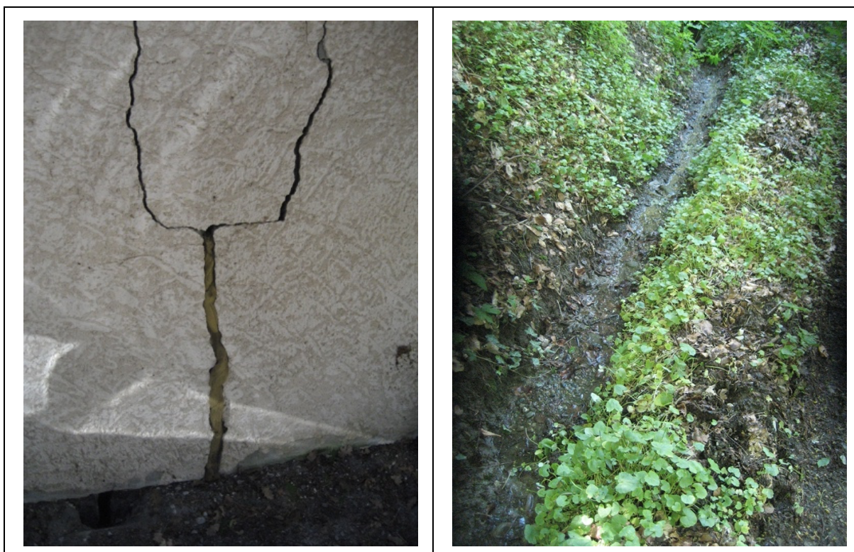
Photos 7 et 8 : Exemples de désordres et de circulations d'eau sur les zones de glissement
