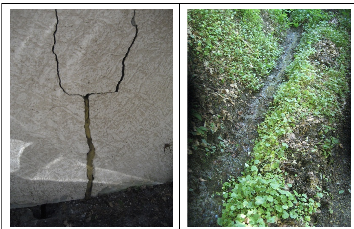
Photos 7 et 8 : Exemples de désordres et de circulations d'eau sur les zones de glissement
