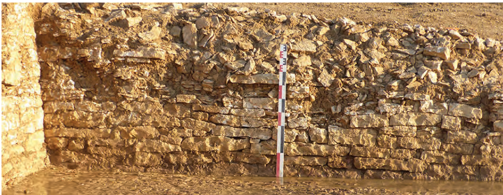
Fig.54 Tronçon du mur Us.119 et son angle avec le mur Us.101. Noter l'état délité de la majorité des pierres du parement © CI.FD
