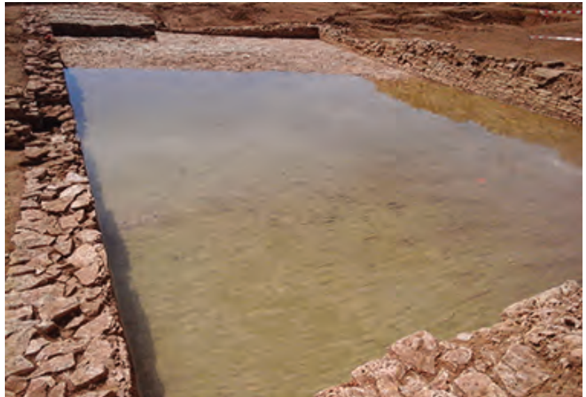
Fig.51 Sur ce cliché, le niveau de l'eau correspond à son point le plus bas lorsque les vannes de vidange étaient ouvertes. La profondeur maximale de l'eau étant alors de 0.30 m dans l'angle nord-est du bassin © CI.FD
