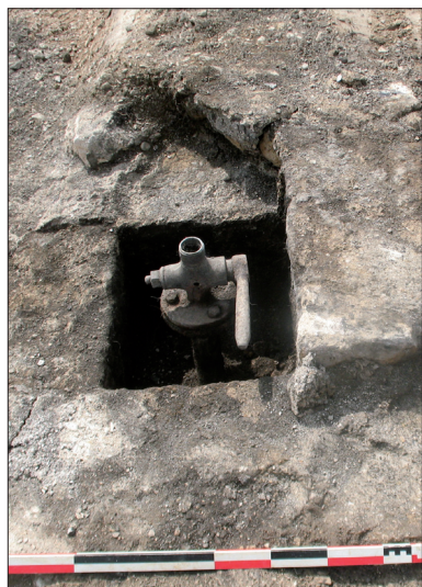
Fig. 31 Vue de détail de la vanne d'ouverture de l'arrivée d'eau en fonte. © F. Devevey
