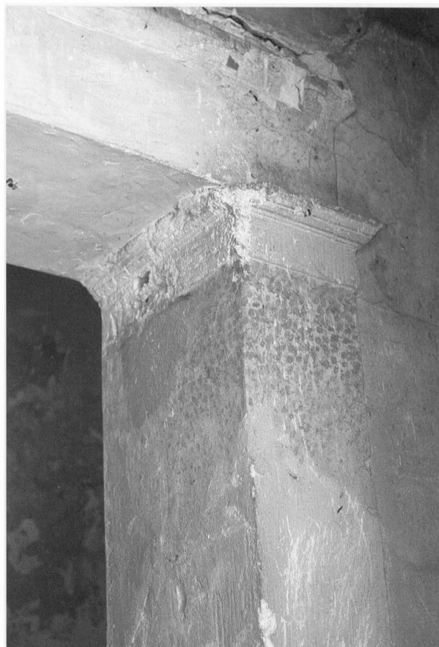
341 - Pilastre d'ante peint en imitation de granite, à l'extrémité de la colonnade séparant le vestibule de l'intérieur.
