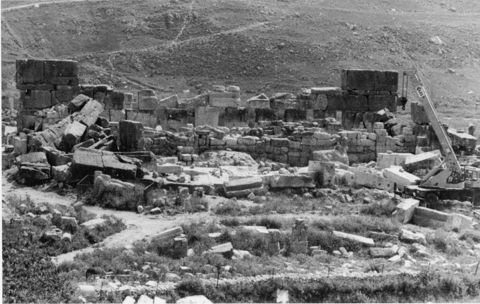
119 - Vue générale de l'effondrement du mur 2.
