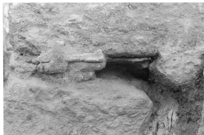
68 - Les claveaux effondrés dans la pièce 4 : le mortier entre les joints.
