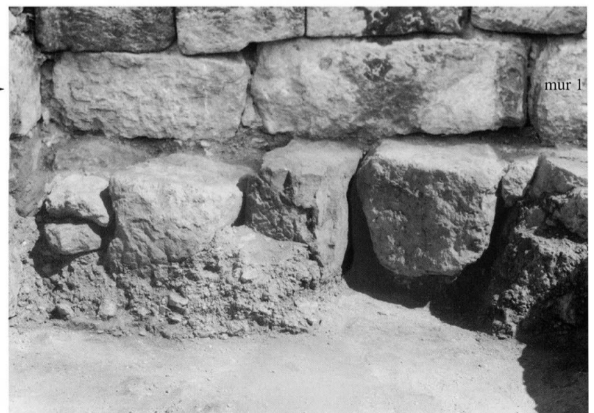
33 - Sondage 3 : le sol blanc qui passe sous l'assise débordante de la fondation du doublage de l'assise 1 du mur 1.
