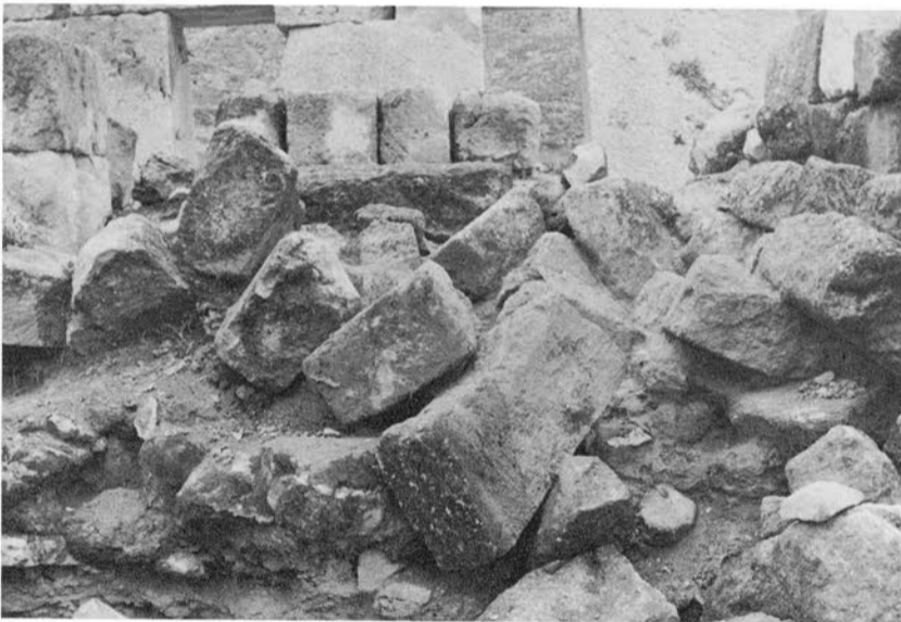
3 - Voûte écroulée du couloir sud.
