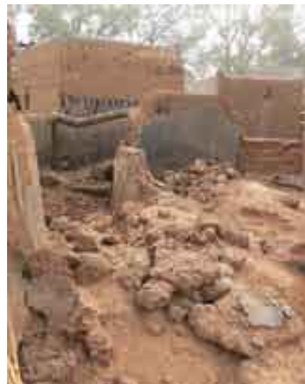
Écroulement de maison suite aux inondation de 2007
