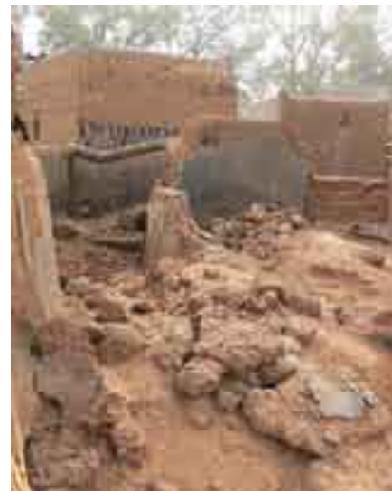
Écroulement de maison suite aux inondations de 2007
