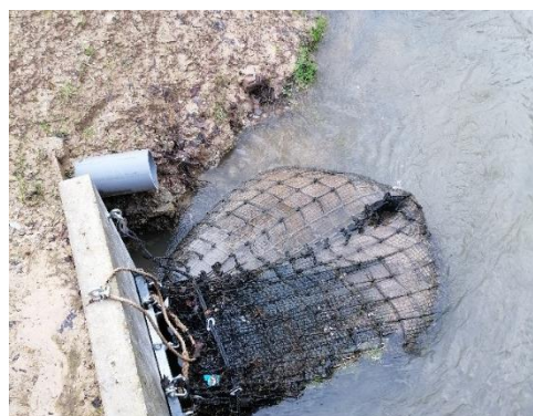
Photo 1 : Filet anti-macrodéchets installé à Malaunay par Pollustock en 2021. Un trop-plein a été installé pour permettre une éventuelle surverse et prévenir la montée en charge du réseau.
