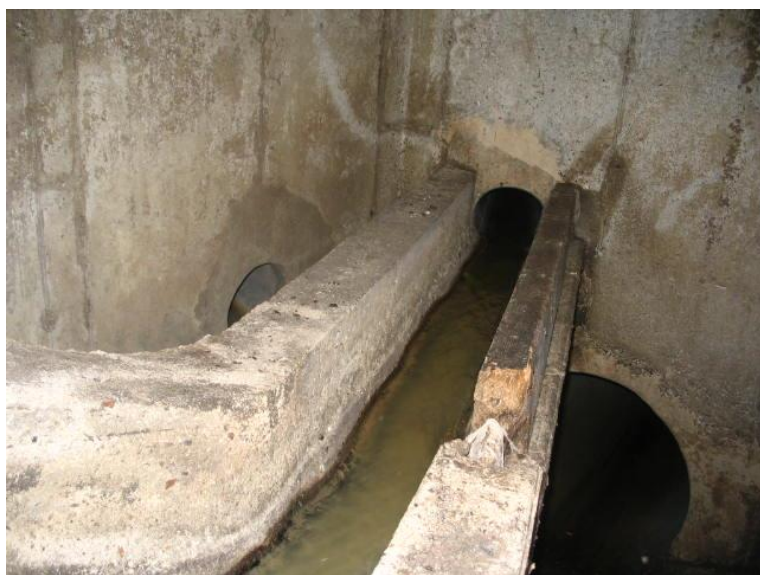
Photo 4 : Déversoir d'orage en amont de l'exutoire rue Georges Pellerin (Zone 2). Les eaux usées peuvent se déverser dans les eaux pluviales en-dessous. Source : Métropole Rouen Normandie.
