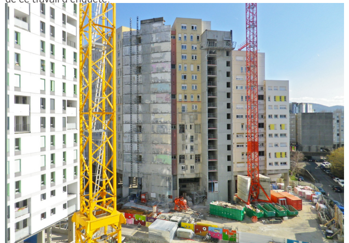
Vue sur le 50 Arlequin depuis les étages du 40 Arlequin. Les traces des appartements démolis apparaissent encore sur la façade du 50, au centre de l'image. Photographie Maïlys Toussaint, 16 mars 2016
