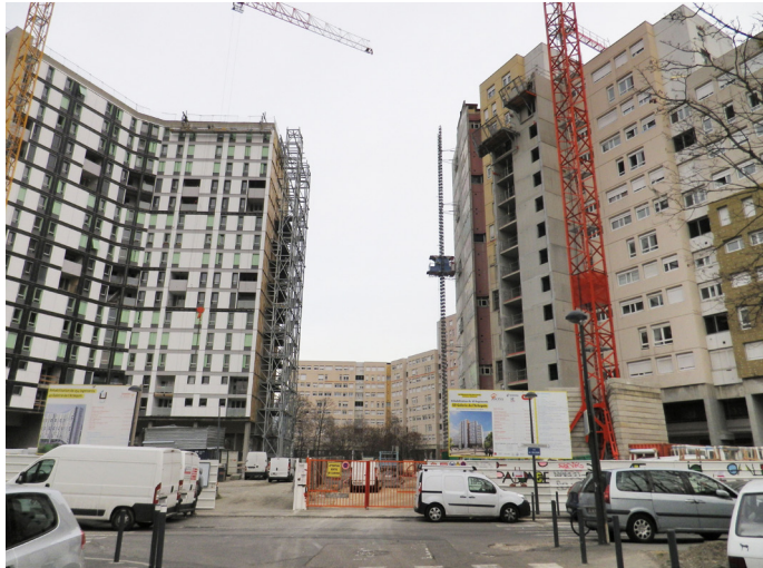
Les montées du 40 Arlequin (à gauche) et du 50 Arlequin (à droite) durant les travaux de réhabilitation. Photographie Maïlys Toussaint, 28 janvier 2016.
