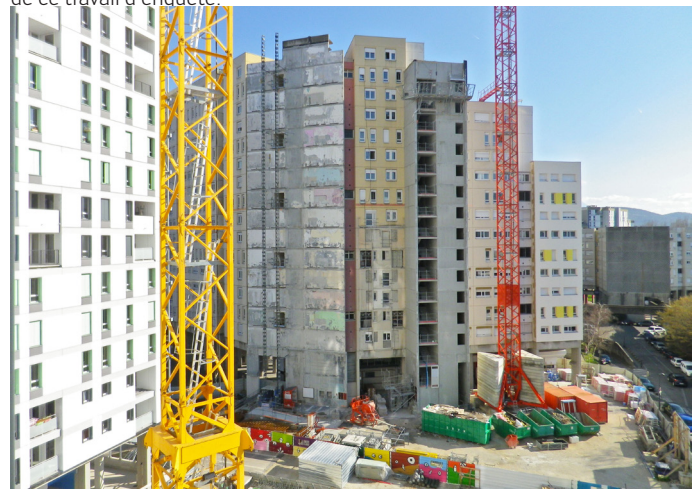
Vue sur le 50 Arlequin depuis les étages du 40 Arlequin. Les traces des appartements démolis apparaissent encore sur la façade du 50, au centre de l'image. Photographie Maïlys Toussaint, 16 mars 2016
