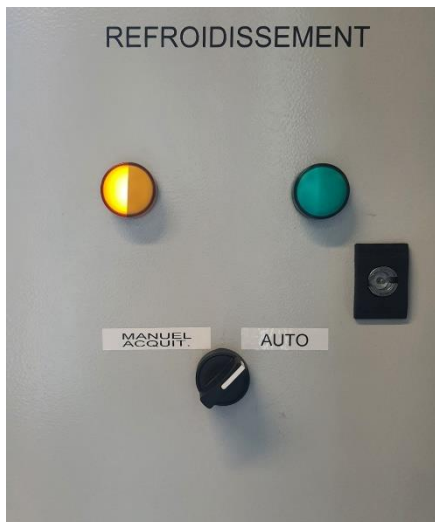
Image e : détection du défaut / signal clignotant
