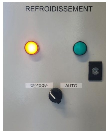
Image f : Acquittement du défaut
