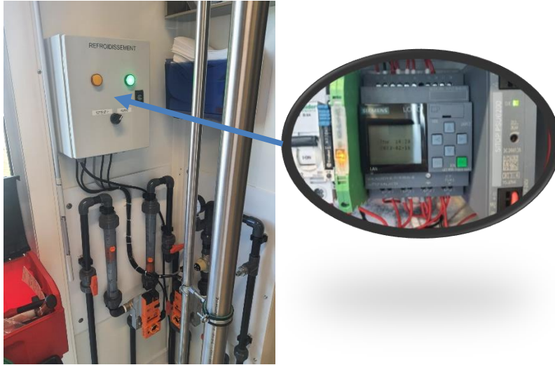
Image b : L'automate et sa baie
