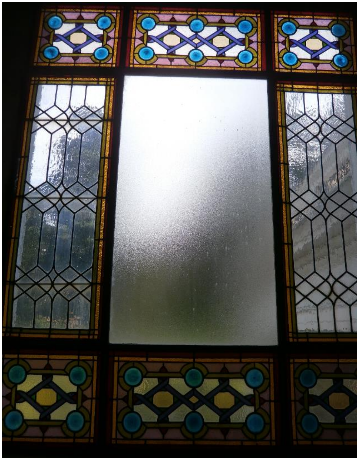
Vue intérieure de la baie éclairant la cage d'escalier, parties en vitraux colorés renvoyant à des motifs décoratifs russisants
