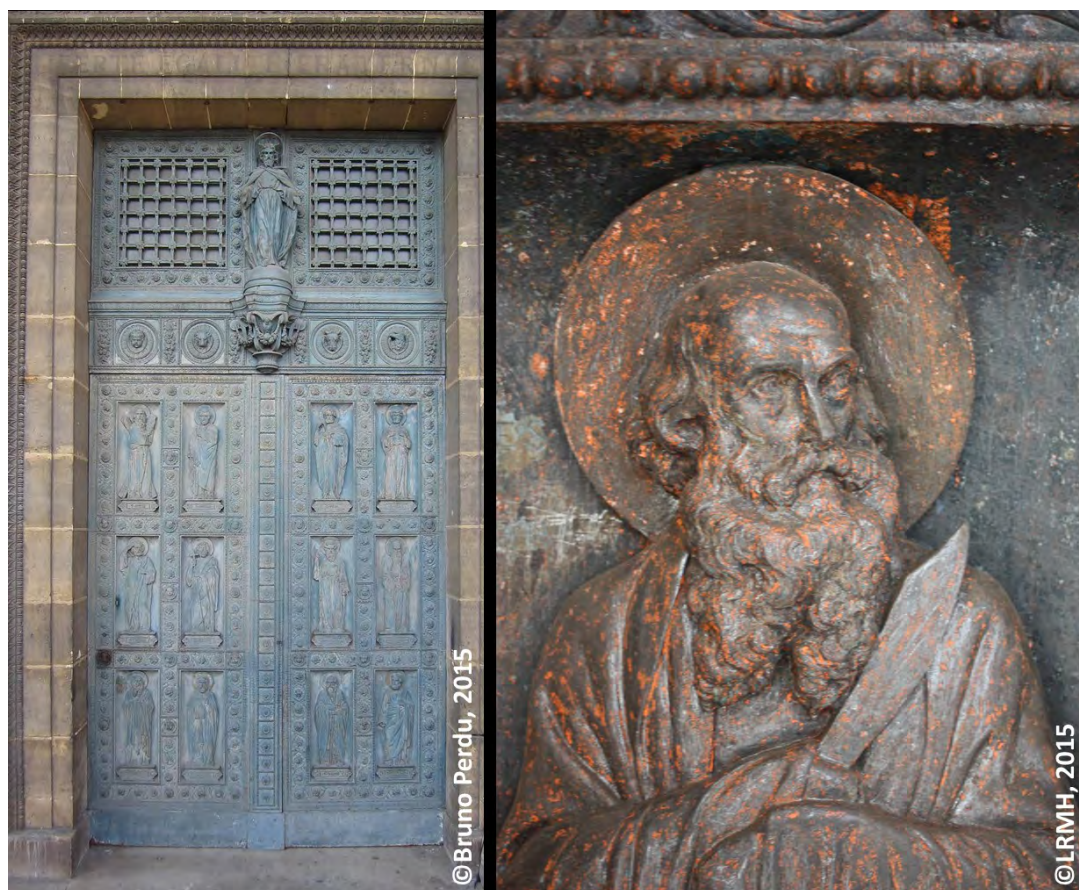
Figure 7. A gauche, porte principale de l'église Saint-Vincent de Paul, avant restauration, Paris ©Perdu ; à droite, statue de Saint Barthélemy dans sa niche, après décapage des couches de peinture ©LRMH 2015.
