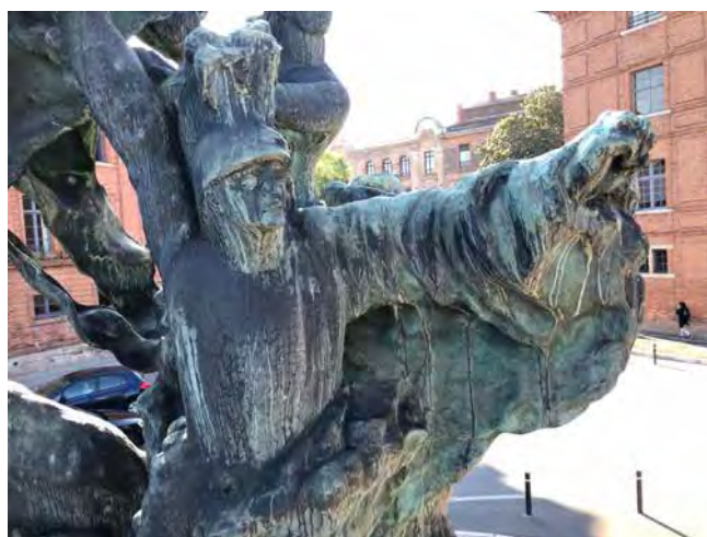
Figure 4. Vue des états de surface – dépôts noirs et patine verte aux endroits de ruissellement des eaux de pluie. © A. Amarger
