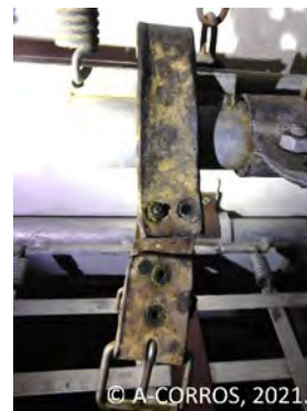
Figure 8. Sangle de couchette encrassée, © A-CORROS 2021.
