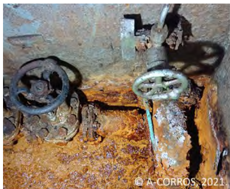
Figure 6. Corrosion généralisée, tranche torpilles, © A-CORROS 2021.
