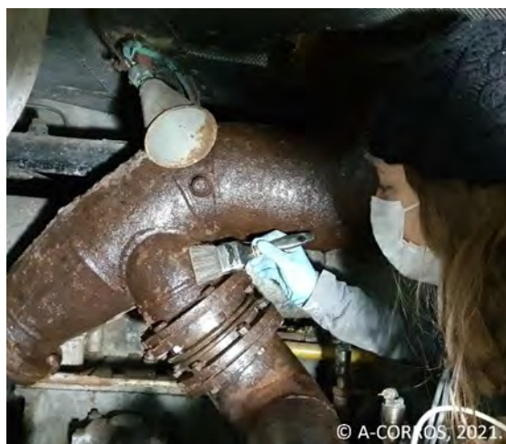
Figure 18. Inhibition d'une conduite en acier, plancher bas, ©A-CORROS 2021.
