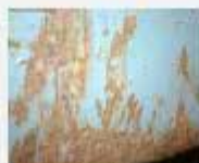
Corrosion du substrat ferreux ©Inp/J.Jouet
