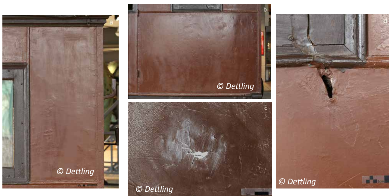
Figure 2. Aspects de surfaces hétérogènes : zone inférieure droite : a. Côté D ; b. Zone supérieure droit, côté D ; c. Masticage, zone inférieure, côté B ; d. Paroi endommagée, côté D. © Dettling
