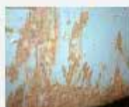
Corrosion du substrat ferreux ©Inp/J.Jouet
