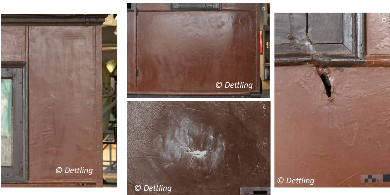
Figure 2. Aspects de surfaces hétérogènes : zone inférieure droite : a. Côté D ; b. Zone supérieure droit, côté D ; c. Masticage, zone inférieure, côté B ; d. Paroi endommagée, côté D. © Dettling
