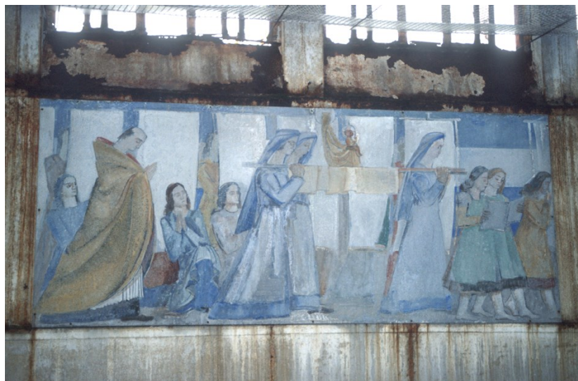
Figure 1 : Plaque n°8 : procession de la vierge noire à Czestochowa - Cliché LRMH. Visualisation des dégradations de la baie de vitrail au-dessus du panneau, des écoulements d'eau et de la corrosion des tôles de fer constituant l'édifice
