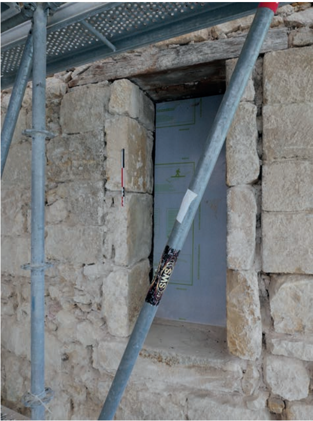
ill. 07 : Tour 6, créneau transformé en fenêtre et dont la largeur a été réduite par un plaquage de dalles contre les piédroits.
