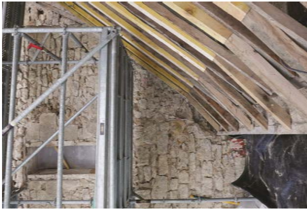
Parement nord de la tour : traces d'arrachement de la maçonnerie de la courtine médiévale transformée en logis
