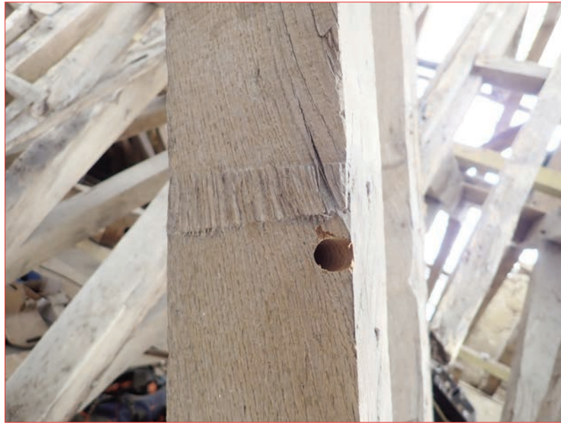
Photo 3 : Traingle d'arrachement des fibres au dos d'un chevron - lucarne ouest sur cour.
