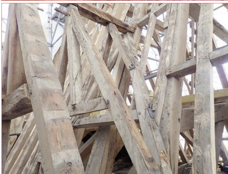
Photo 1 (en haut) : Vue de la charpente découverte de la lucarne ouest sur cour. Photo 2 (en bas) : Ferme inclinée contre la charpente du logis (à droite) - lucarne ouest sur cour.
