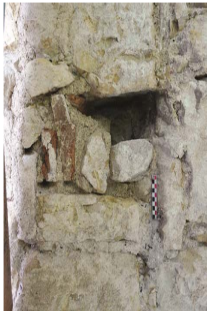
Tour 8. trou de hourd bouché en profondeur.
