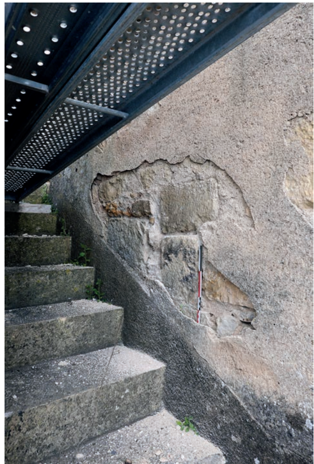
ill. 04 : Piédroit d'une archère murée, rendue inutilisable par la construction de l'escalier (UM 13, coursière).
