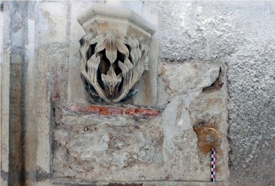
ill. 44 : Façade sur cour du bâtiment EST du logis, culot réinséré de la fenêtre du rez-de-chaussée.
