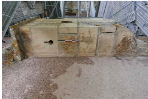
Tour 8, l'enduit coloré recouvre l'intégralité des maçonneries mais la couche supérieure est tombée par endroits
