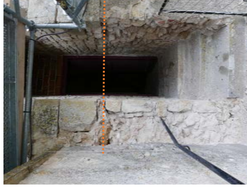
Tour 6, restitution du niveau d'accès d'origine à la tour depuis la courinne, plus haut que le niveau actuel
