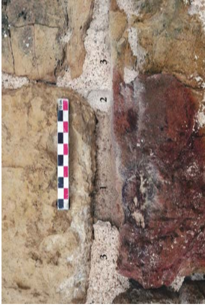
Courine SUD, extrémité sud du parement ouest. 1 correspond au mortier de construction, 2 correspond à l'enduit de la porte du château appliqué en partie sur la courine ; 3 correspond à l'enduit le plus récent de la courine
