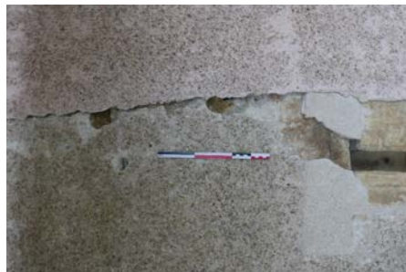
Tour 6, détail de la césure entre l'enduit brun-gris (à gauche) et l'enduit rose (à droite).
