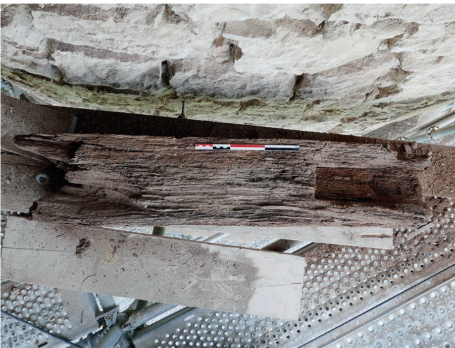
ill. 14 : Pièce de bois du hourd de la tour 6 après dépose, face supérieure avec encoche.
