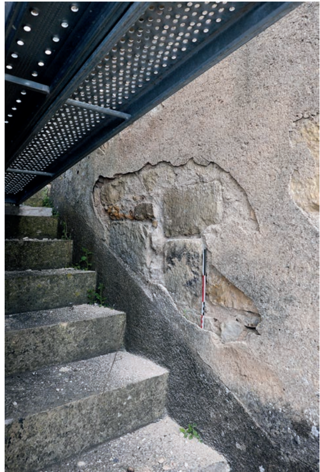
ill. 04 : Piédroit d'une archère murée, rendue inutilisable par la construction de l'escalier (UM 13, coursière).
