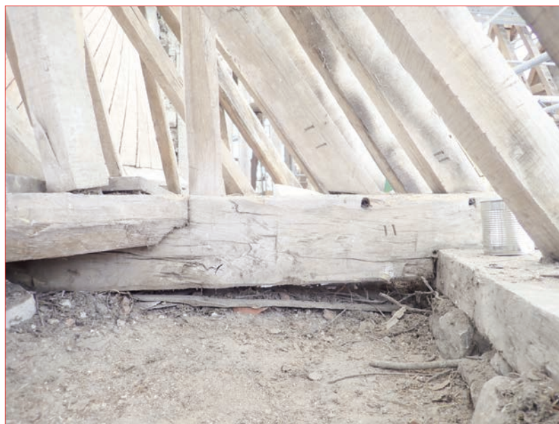
Photo 6 (en haut) : Triangle d'arrachement des fibres au dos d'un chevron - tour n° 8.
