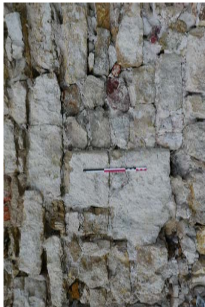
Parement oriental de la courtine : fente de tir la plus au nord, démontée puis murée
