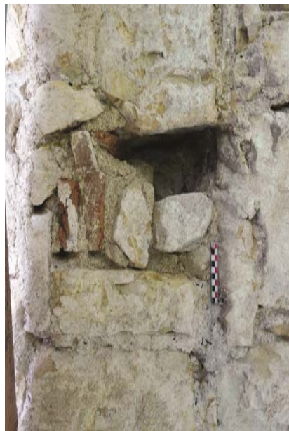
Tour 8. trou de hourd bouché en profondeur.
