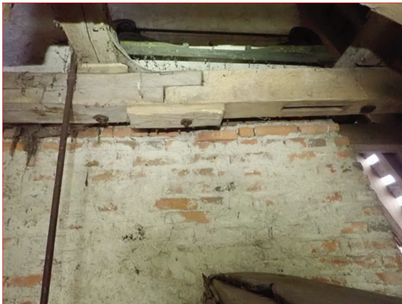
Photo 15 (en haut) : Vue du contreventement longitudinal de la charpente du logis nord.
