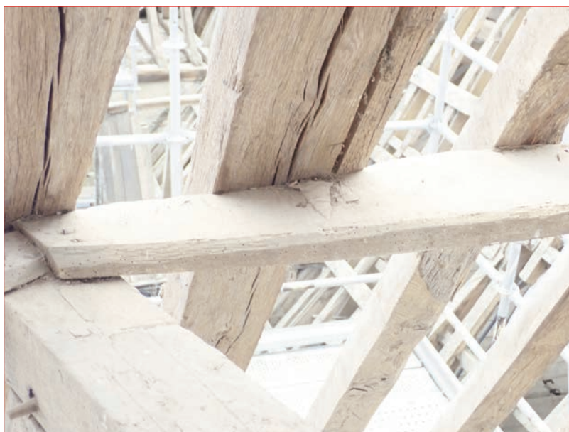
Photo 11 (en haut) : Chevron avec un embrèvement simple en pied - tour n° 7. Photo 12 (en bas) : Panne sur un entrait retroussé - tour n° 7.
