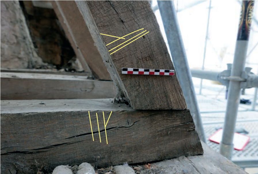
ill. 40 : Marques « III » avec langue de vipère, incisées sur l'entrait et le chevron de la charpente de la lucarne-pignon du versant OUEST du corps de bâtiment EST.
