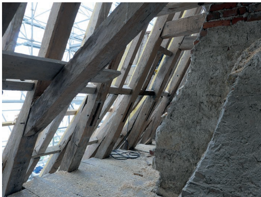
ill. 42 : Aisseillers manquants sur la sous-face NORD des fermes F12 ; F13 et F14 du corps de bâtiment NORD.
