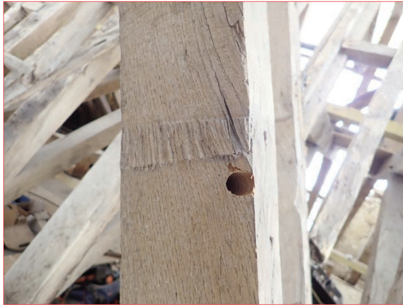
Photo 3 : Traingle d'arrachement des fibres au dos d'un chevron - lucarne ouest sur cour.
