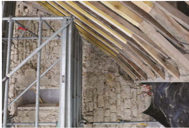
Parement nord de la tour : traces d'arrachement de la maçonnerie de la courtine médiévale transformée en logis
