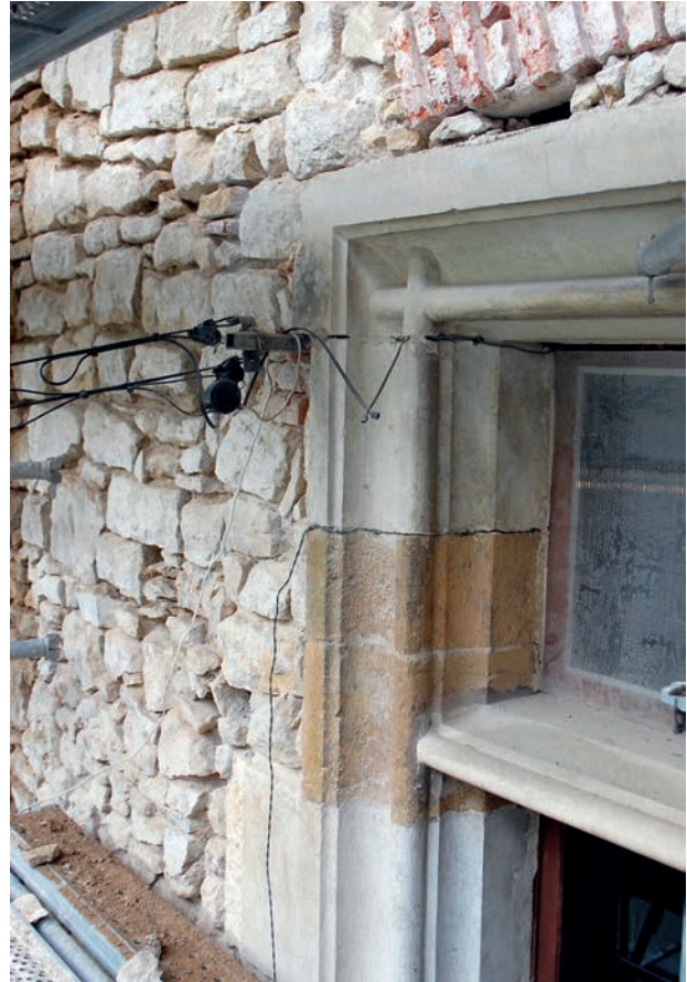
ill. 39 : Appareil de la fenêtre UC 7.6, remploi en calcaire orange de l'état II et arc de décharge en briques.
