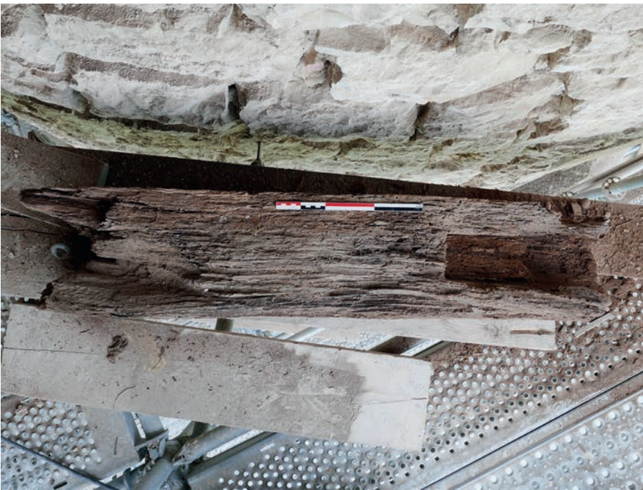
ill. 14 : Pièce de bois du hourd de la tour 6 après dépose, face supérieure avec encoche.
