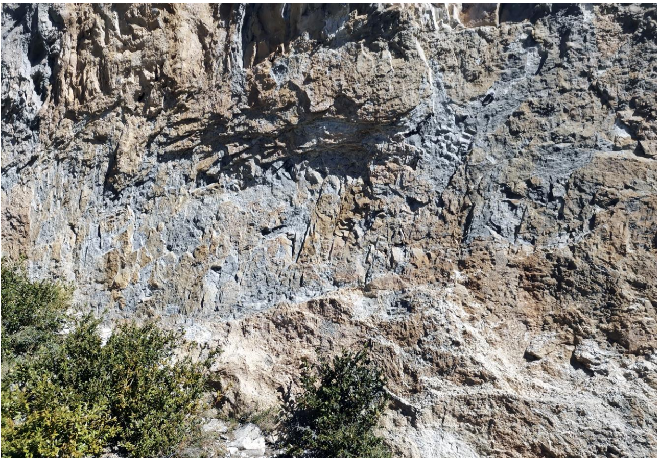
Fig. 5 : Zone écroûtée en amont
