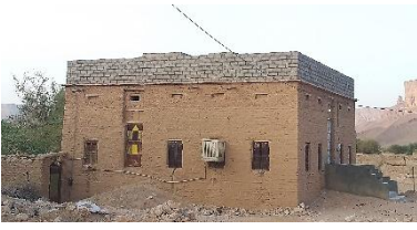
الطوب الطيني والكتل الاسمنتية، محافظة حضرموت، مديرية الرخية، ٢٠٢٢ © جمعية رعاية الأسرة اليمنية
