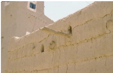
نظام تصريف جيد للسقف العلوي مصنوع من الخشب، وتصريف مياه الأمطار بعيداً عن الواجهة © المركز الدولي للعمارة
