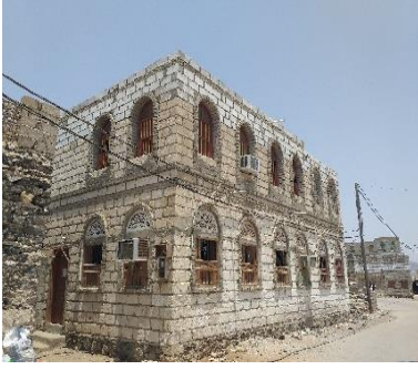
جدران حجرية مجتمعة مع إطار خرساني، شبوة، مديرية رضوم، ٢٠٢٢ © جمعية رعاية الأسرة اليمنية
