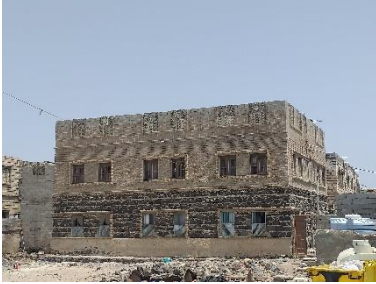
البناء الحجري والكتل الاسمنتية، محافظة شبوة، مديرية رضوم، ٢٠٢٢ © جمعية رعاية الأسرة اليمنية
