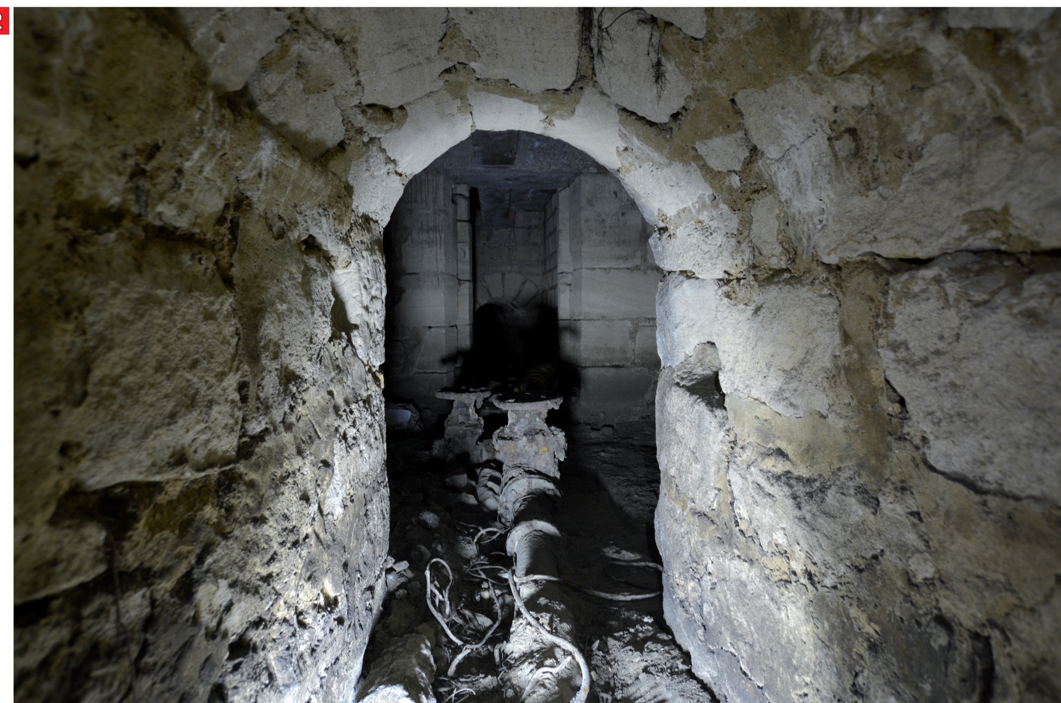
2 Le regard qui permettait l'accès aux conduites pour la maintenance a été arasé en surface pour le nivellement de la chaussée. Les deux canalisations sur lesquelles sont installées des vannes d'arrêt reposent dans un bassin rectangulaire. © N. Samuelian, Inrap
