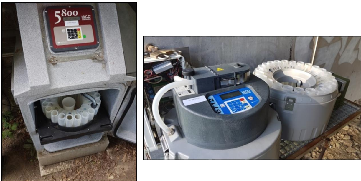
Figure 4 : A gauche, préleveur réfrigéré à la station aval (pont de Signy), à droite préleveur non réfrigéré sur la station amont (pont de Virey).
