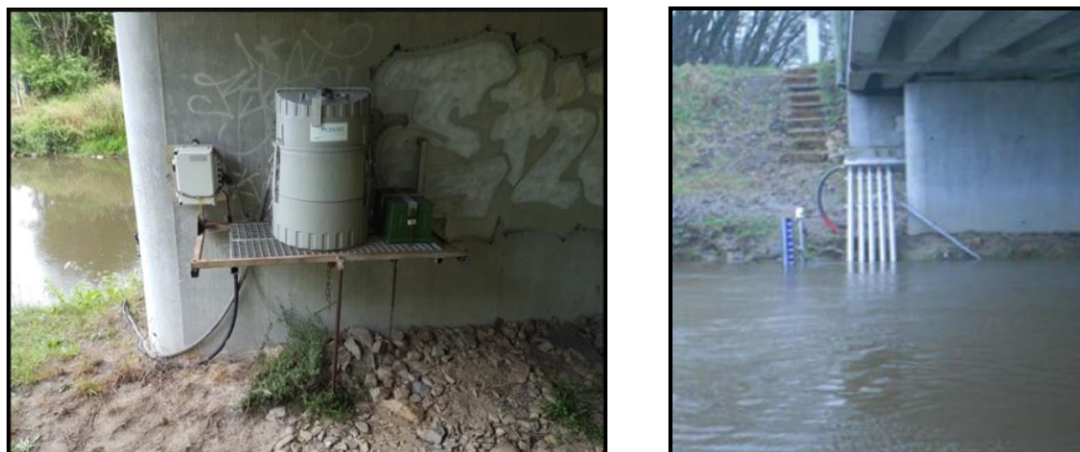
Figure 3 : Station de Virey, à l'amont (EDF-INRAE), à gauche : le préleveur installé par INRAE, À droite : les sondes et le dispositif de suivi installés par EDF
