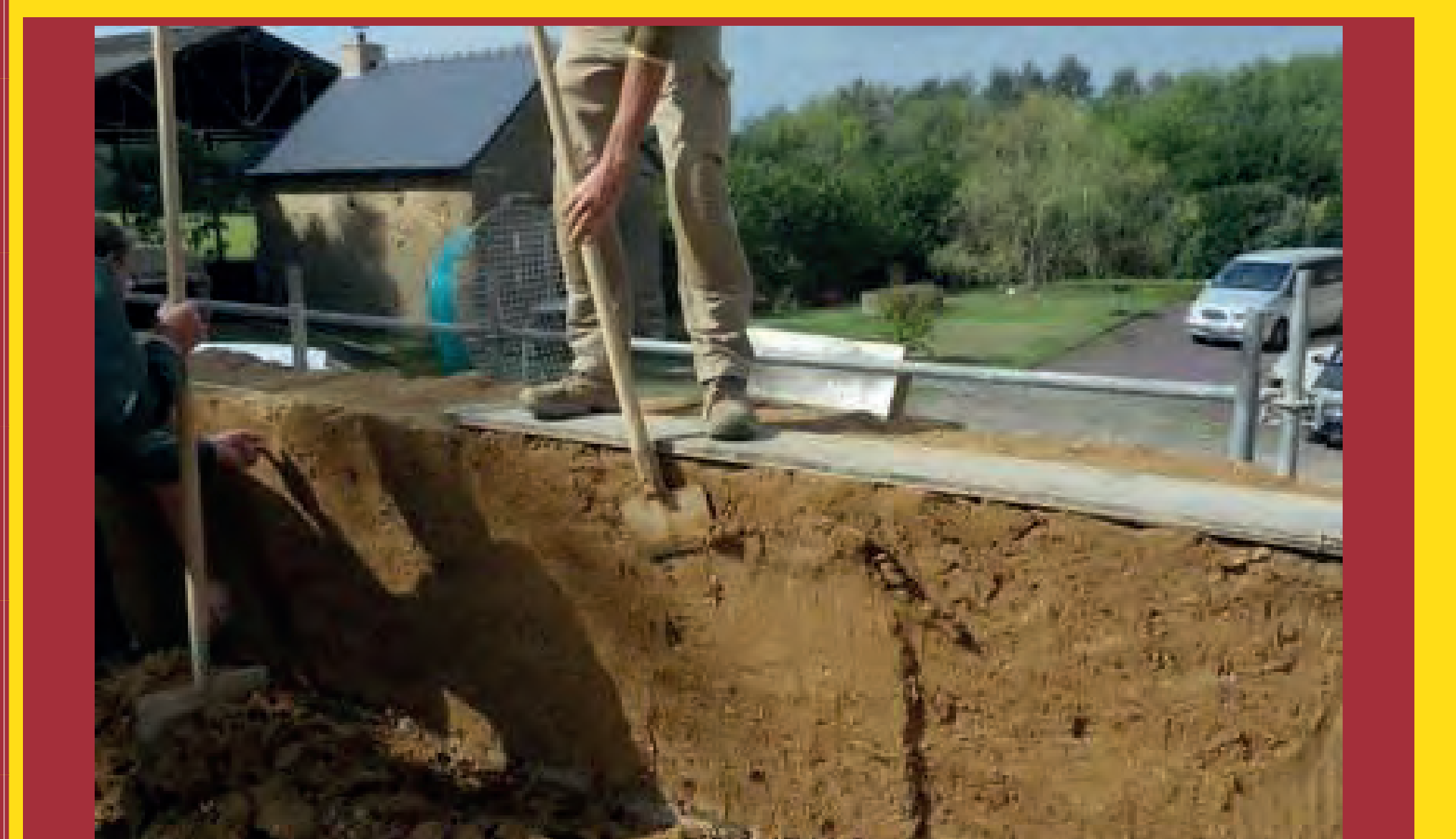
Lors des dernières journées du patrimoine à la Frinière à Cesson-Sévigné, près de Rennes (35). Démonstration du montage d'un mur en bauge. Ici le maçon utilise sa paroière pour rectifier la verticalité de sa levée.
