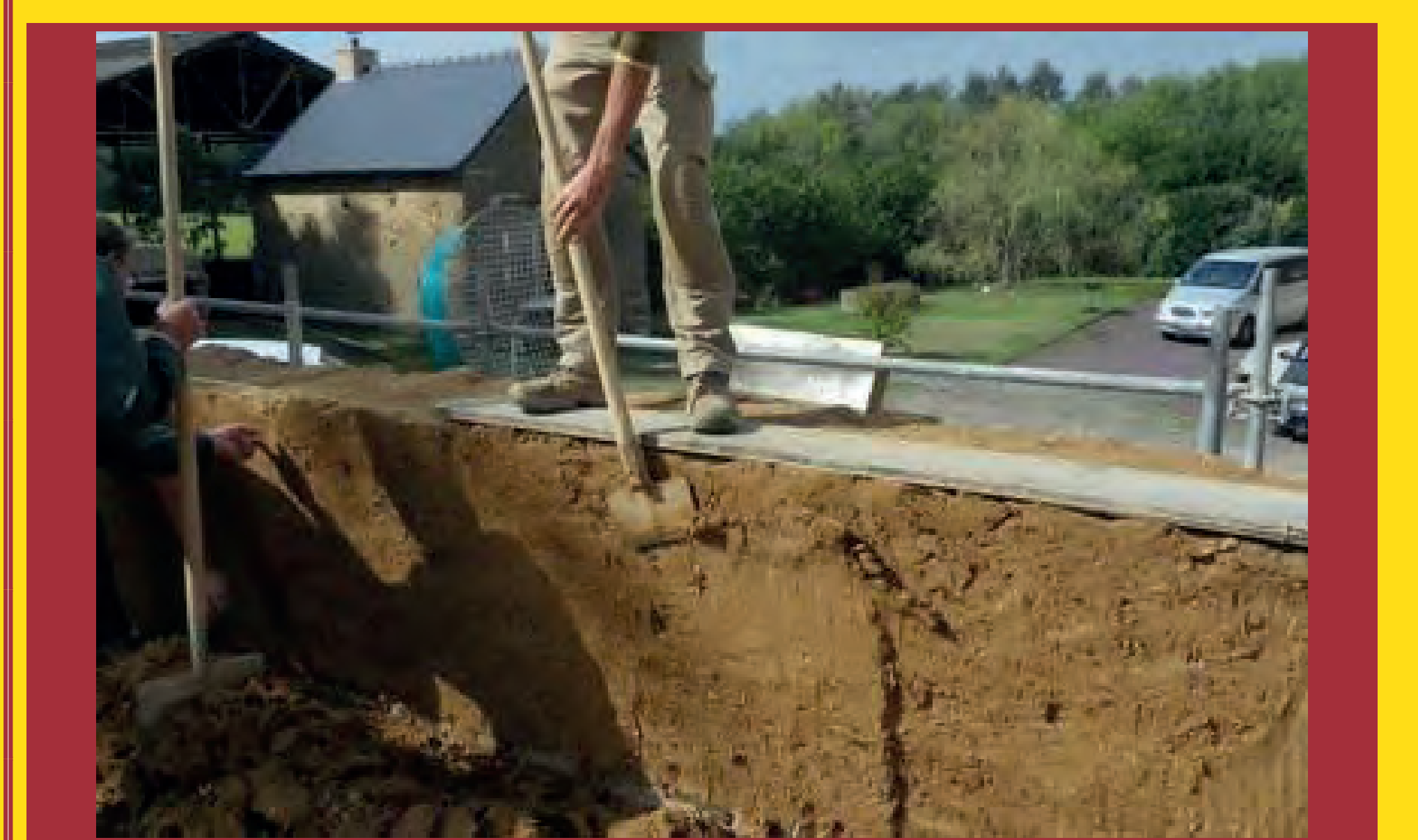
Lors des dernières journées du patrimoine à la Frinière à Cesson-Sévigné, près de Rennes (35). Démonstration du montage d'un mur en bauge. Ici le maçon utilise sa paroière pour rectifier la verticalité de sa levée.
