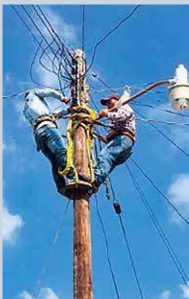
6. Deux électriciens travaillant sur la ligne basse tension, pour raccorder plusieurs foyers au réseau électrique. Municipalité de Ocosingo, Novembre 2019.
