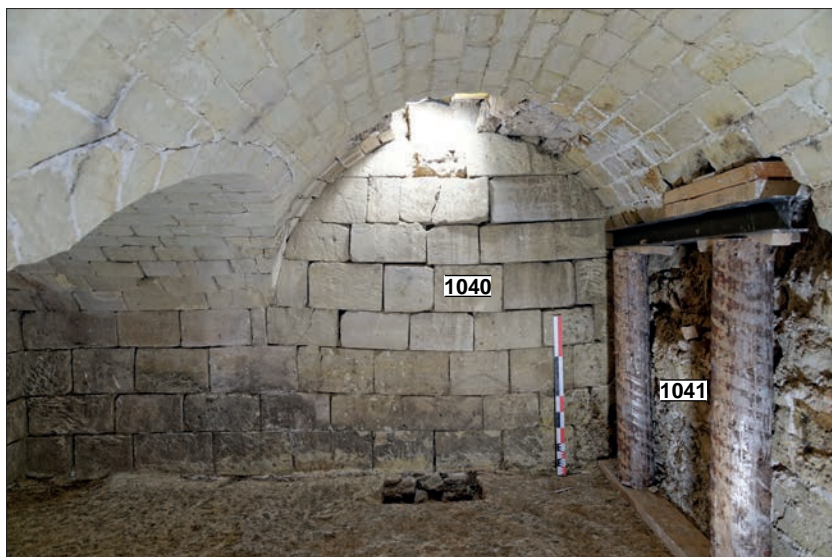
Fig. 104 Détail du mur 1040 et section endommagée de 1041.
