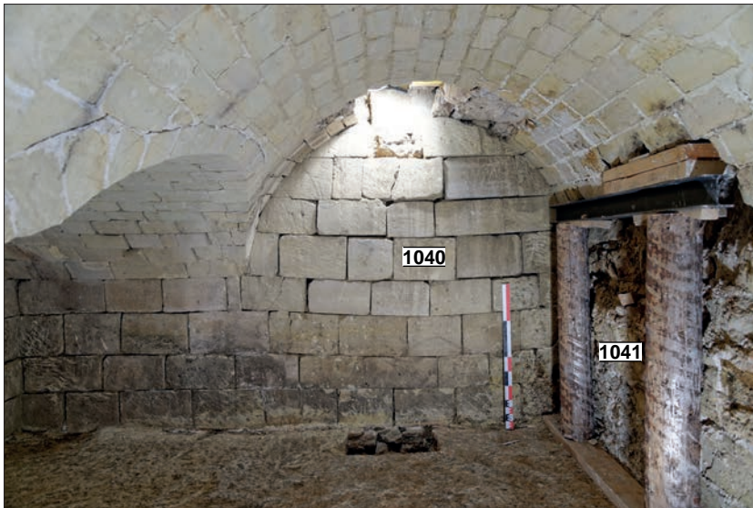
Fig. 104 Détail du mur 1040 et section endommagée de 1041.
