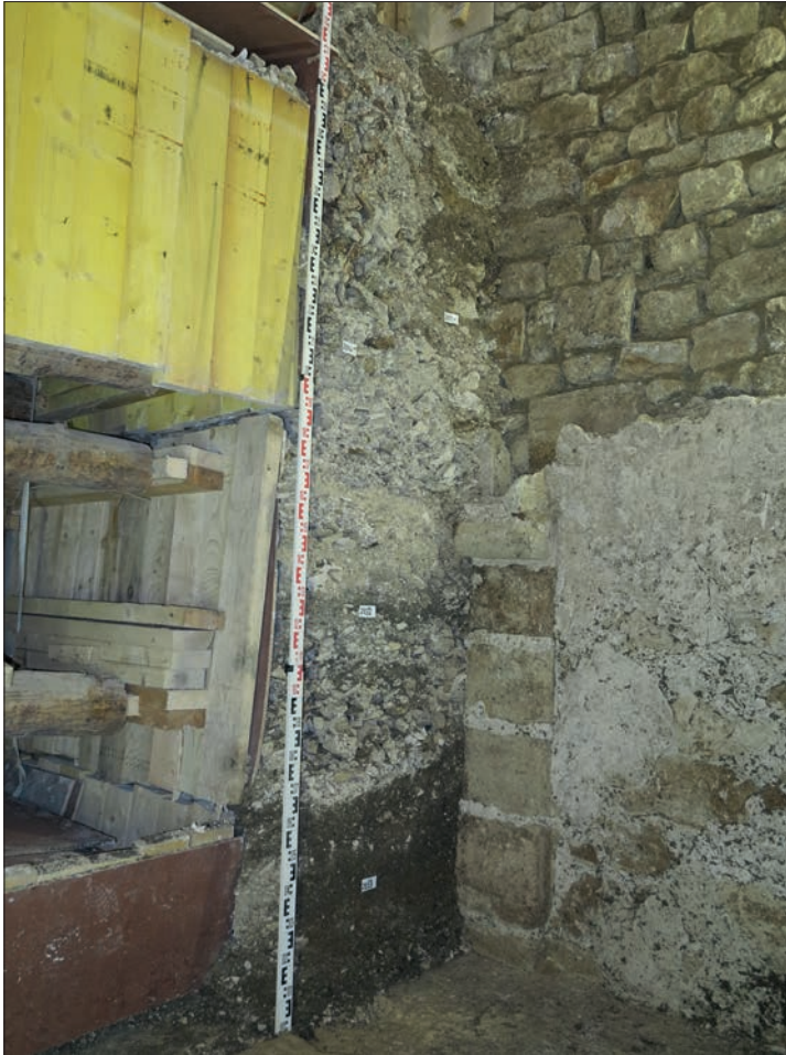
Fig. 107 Le comblement de la salle 1 avec le coffrage du puits blindé de la phase 1 encore en place. Les remblais de comblement qui entouraient ce coffrage ont été fouillés, puis le coffrage démonté. Cliché : J. Avinain (DHAAP/ville de Paris).
